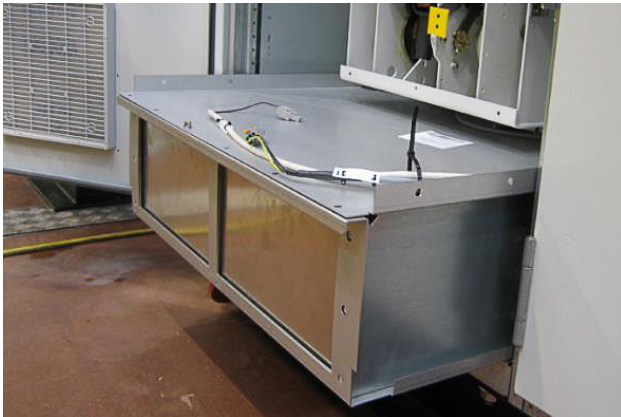
Figure 10–136 Fan drawer below the GEB
